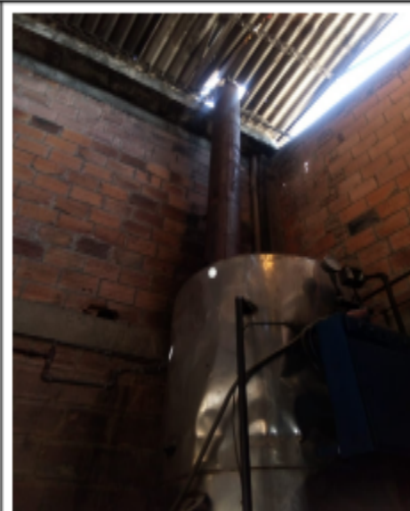
Fotografía No. 4 Ducto de desfogue de la caldera de 40 BHP que opera con retal de madera.
