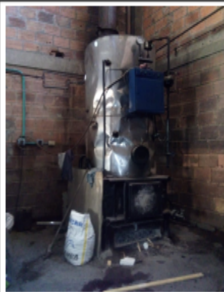
Fotografía No. 3 Caldera de 40 BHP que opera con retal de madera
